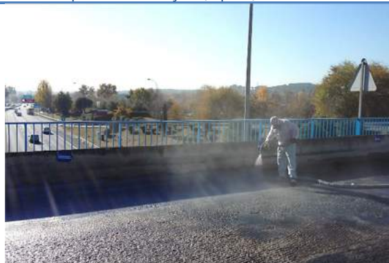
TVP1. Tablero de Puente. Puente del Palacio de La Moncloa, M-30, Madrid (España)
