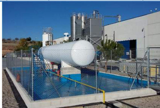
DEP3. Depósitos. Cubetos de retención secundaria. Industria química Guadalajara (España)
