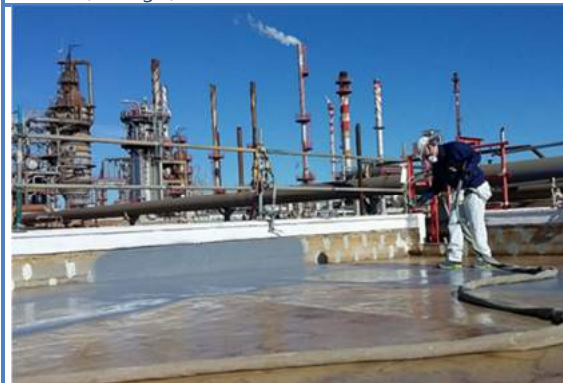
NTV8. Cubierta plana no transitable. Industria química, con partículas en suspensión (Portugal)
